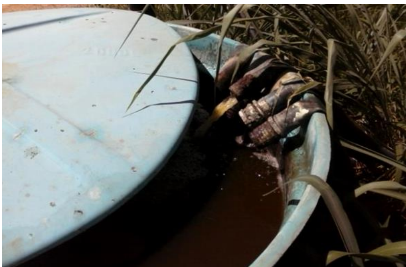
Figura 12: Tanque de equalização do aterro sanitário da BR-040.
